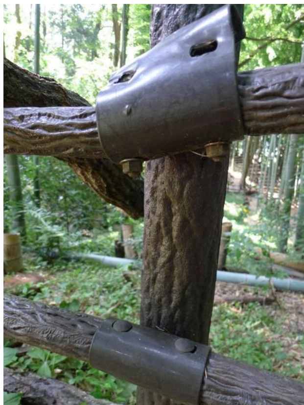
上⇒金具破損状況 下⇒金具正常 比較 4
